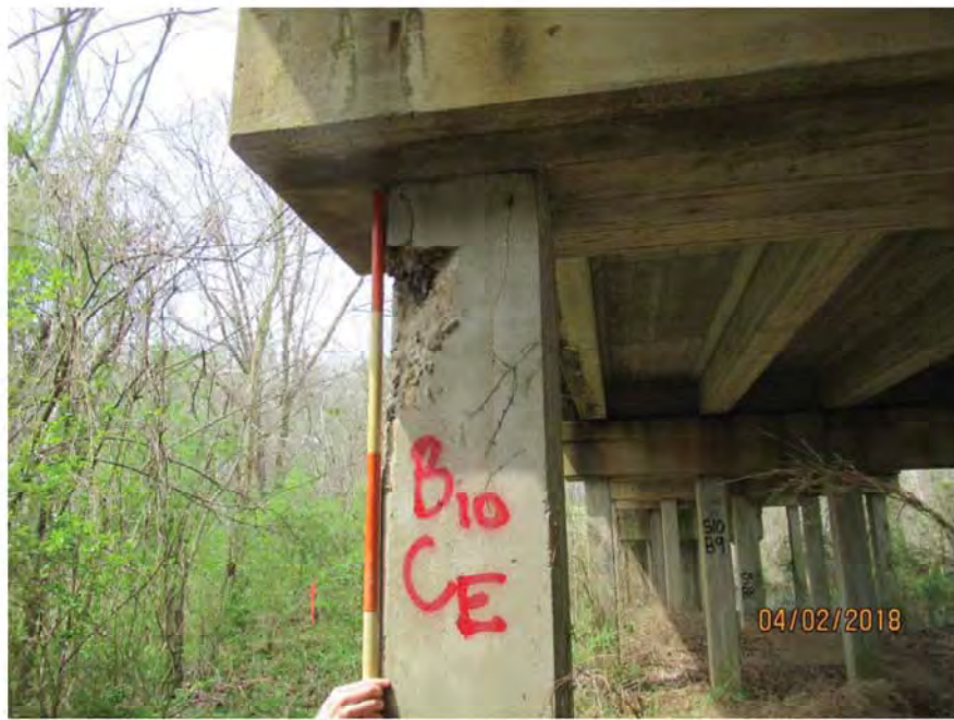
BENT 10 - COLUMN E - SPALL
