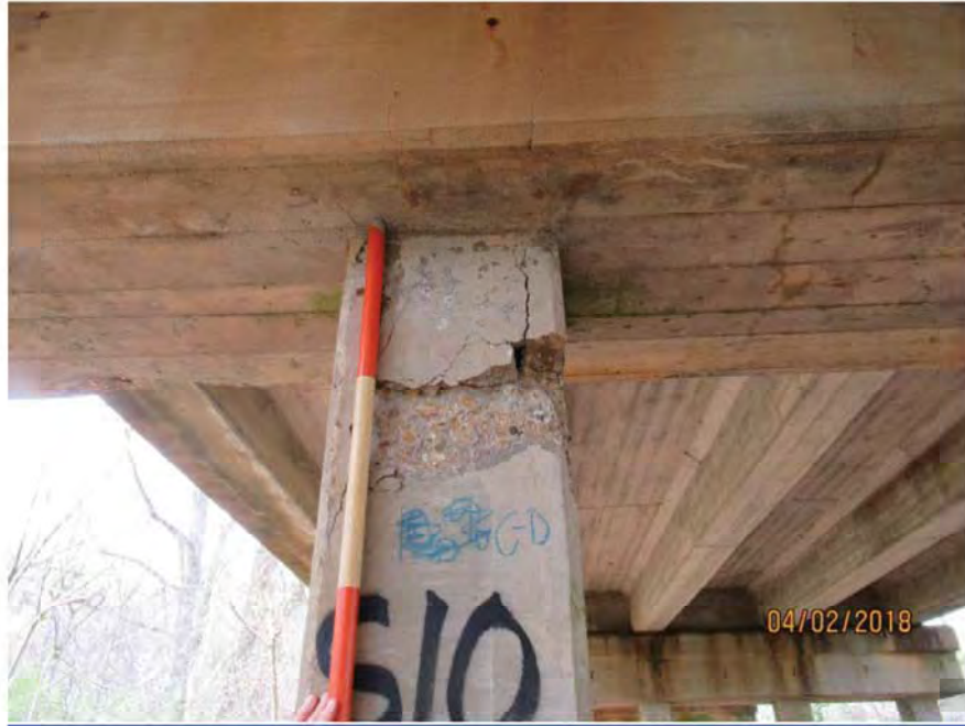
SPAN 10 - BENT 9 - COLUMN D - SPALL
